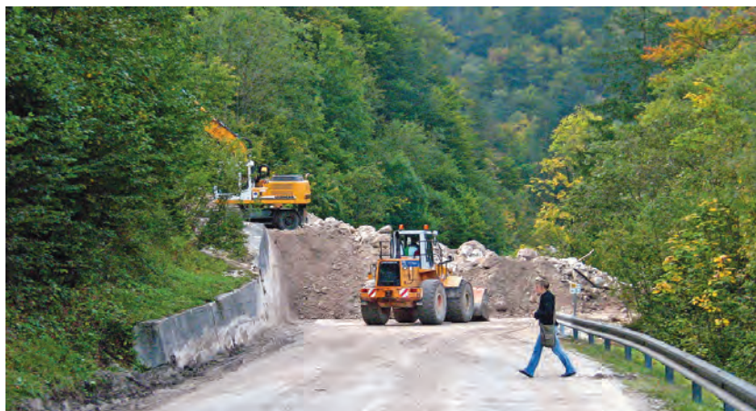
Slika 3: Erozijski procesi povzročajo materialno škodo z oviranjem prometa. Foto: Aleš Zdešar.
