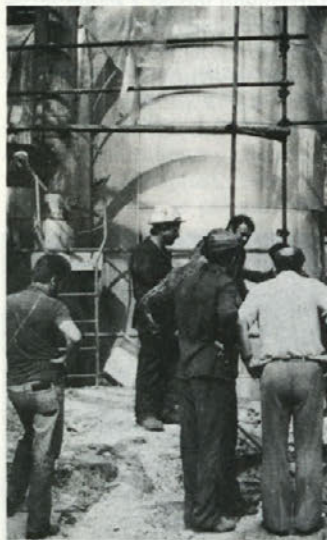
Delavci so imeli težave z dotrajanostjo temelja rezervoarja.
