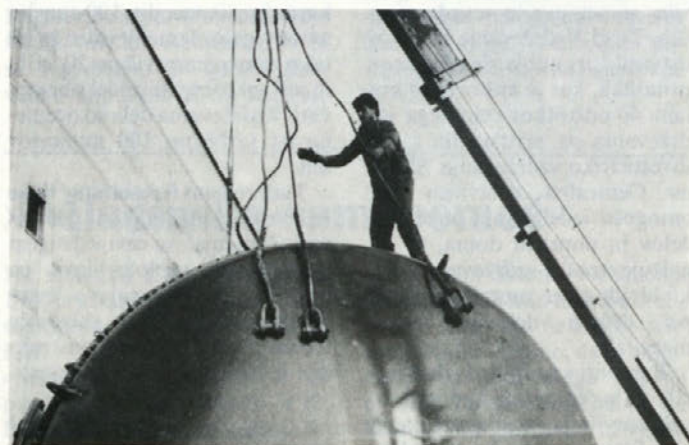
Elektrofilter je bil težak 18 ton
