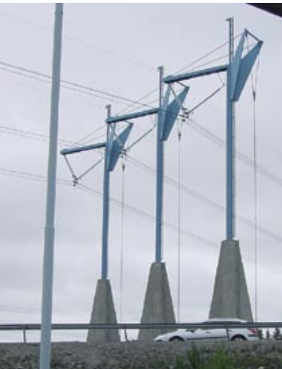
Okoljski steber 400 kV ob avtocesti.
