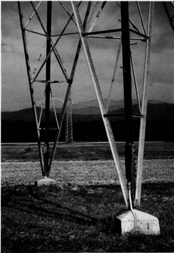
Slika 3. Korozija posameznih delov električnega daljnovoda zaradi neustrezne kemične sestave jekla
