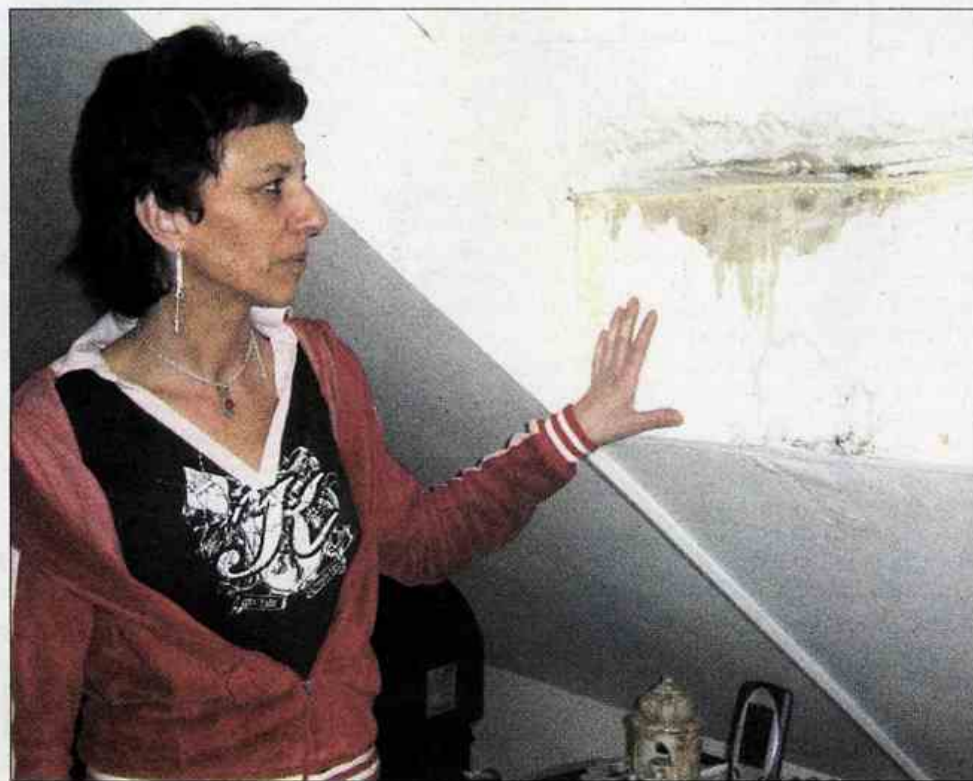
Zgolj en detajl njenega, že tri leta začasnega doma na Frankolovem.
