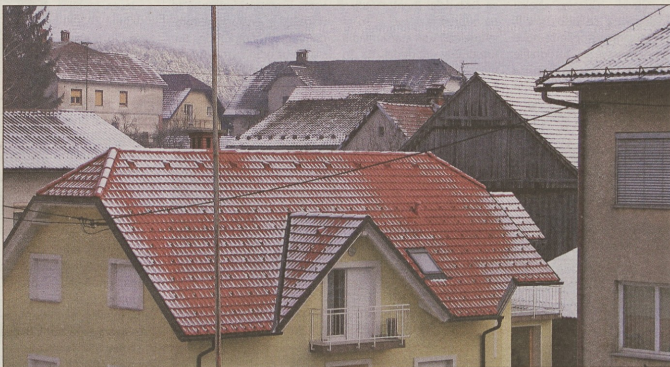
Sneg na strehi nam z rentgensko natančnostjo pokaže vse toplotne izolacijske napake pod streho. Najbolj izraziti so neizolirani zidovi ter ne dovolj debele toplotne izolacije. Tu izgublamo toploto vso ogrevalno sezono, tu nam v stavbo prihaja mraz, ki je osnova za plesen.
