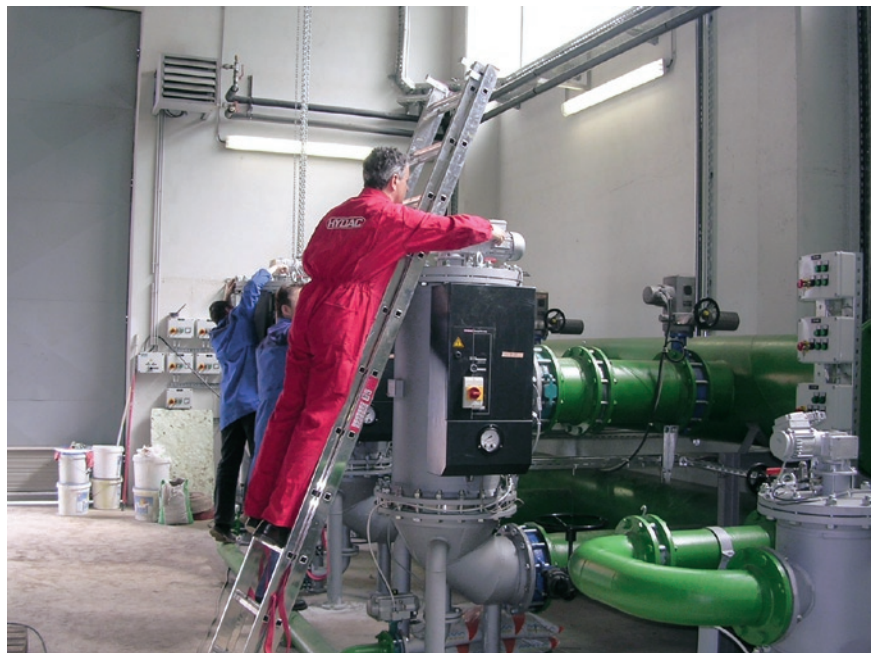
D. Grgić pri preskušanju delovanja filtra za vodo v jeklarni Acroni Jesenice
