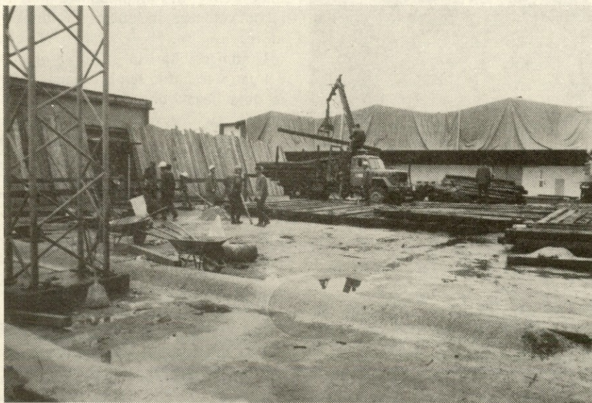
Kljub dobri zaščiti je popokala večina stekel na skladišču (bila so zavarovana)...
