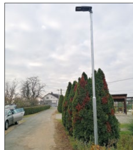
Del javne razsvetljave je izgrajen na enem od odsekov v Hajdošah.
