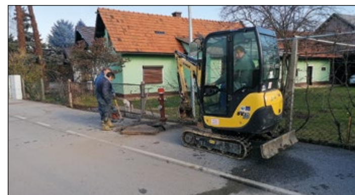
Zamenjava poškodovanih hidrantov po Občini Hajdina (na fotografiji nova hidranta v Slovenji vasi in Draženih)
