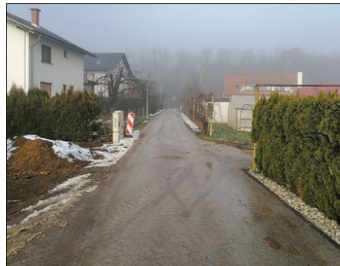
V naselju Zg. Hajdina preko proge gradbinci še pred koncem leta v zemljo polagajo električne kable.
