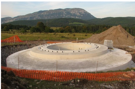
Slika 5: Temelj vetrne elektrarne Dolenja vas [9]
