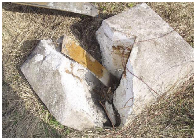
Slika 13 • Temelj globalno nepoškodovan, poškodovana glava zaradi slabe izvedbe – armatura!?
