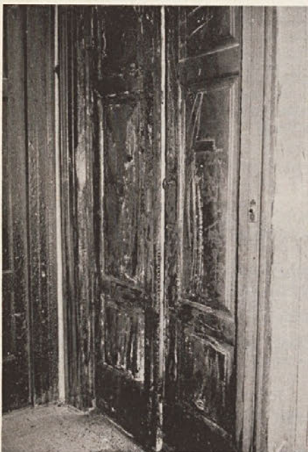
Hudo poškodovana vrata Cuffarovega stanovanja
