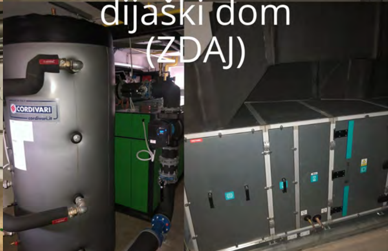
KOTLOVNICA - šola (ZDAJ)
