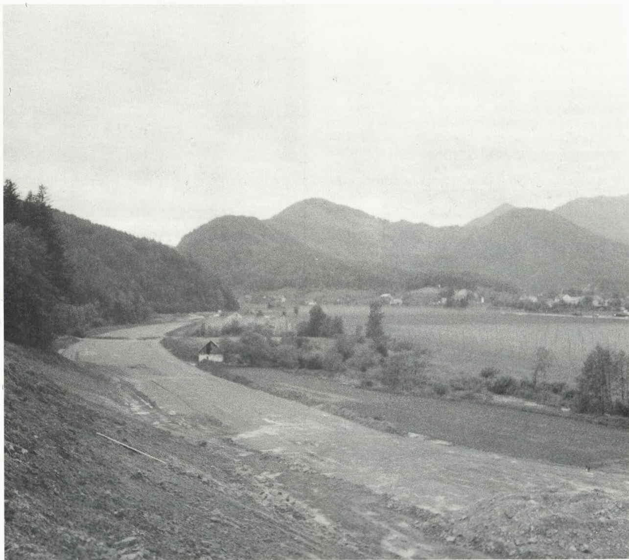
Gradnja avtoceste skozi Savinjsko dolino se je že začela na odseku Ločica - Brode
