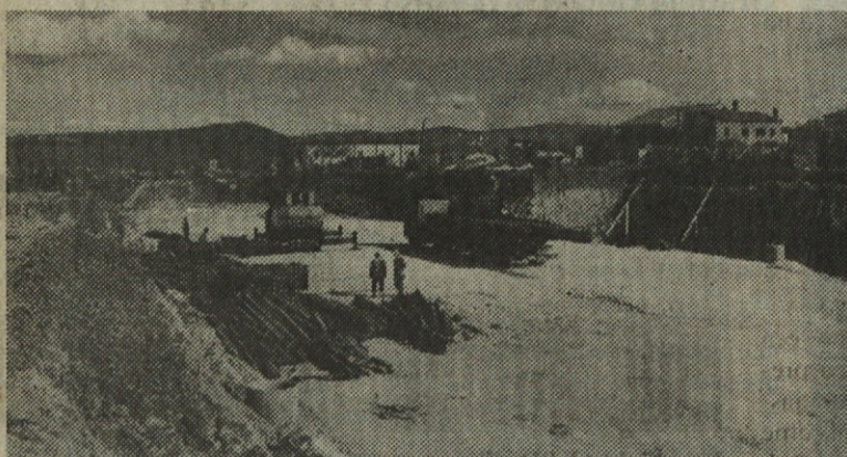
Pogled z nasprotne strani nasipa na traso avtoceste. Tu bo postavljen nadvoz »gazela«, ki bo omogočal zunaj nivojsko križanje Bertoške vpadnice z avtocesto (Bertoki so, če gledate sliko, na desni strani).
