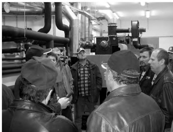
Kotlovnica na lesne sekance, ki ogreva naselje Luče ob Savinji.
