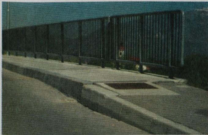
Poškodba nadvoza na Gorjuši
