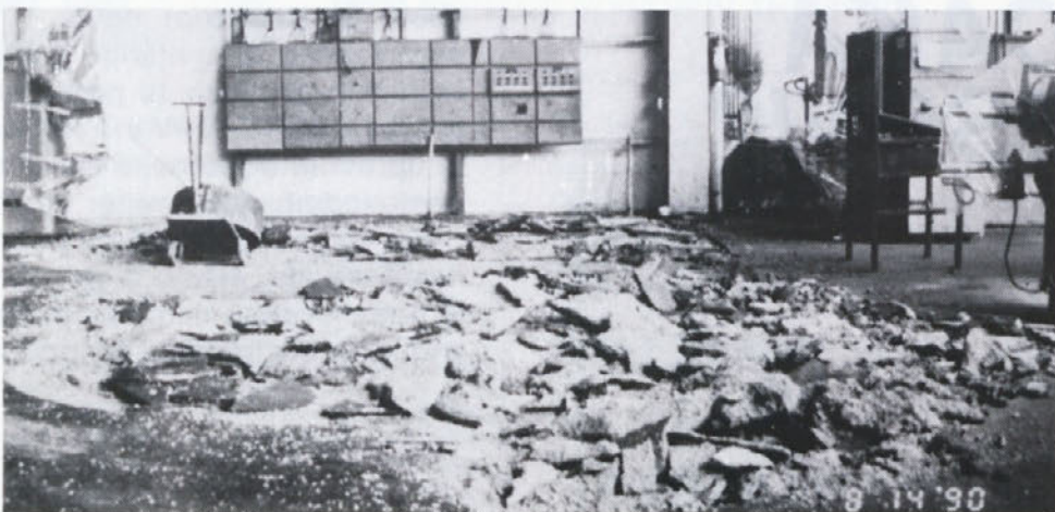
Počena vodovodna cev v karoseriji je povzročila dodatno delo gradbincem in skupini za vzdrževanje energetskih naprav. Materialna škoda zaradi uničenih tal je tudi velika.
