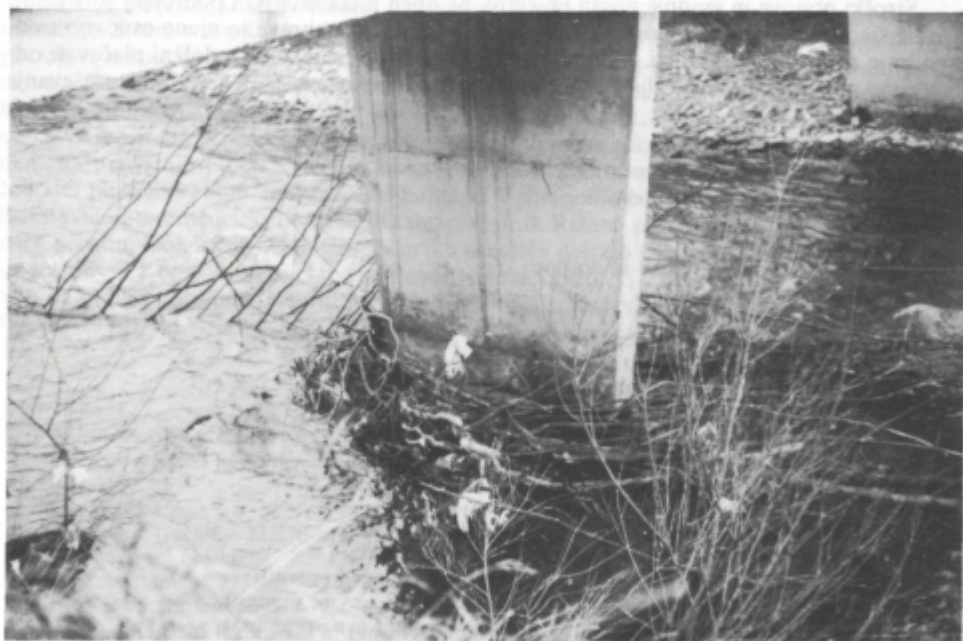
Sl. 10. Ob mostovih preko Rižane se predvsem ob visoki vodi nabira dračje ter zastaja material, zlasti na odsekih kjer poteka železnica stran od struge in le ta ni poplavljena in regulirana
