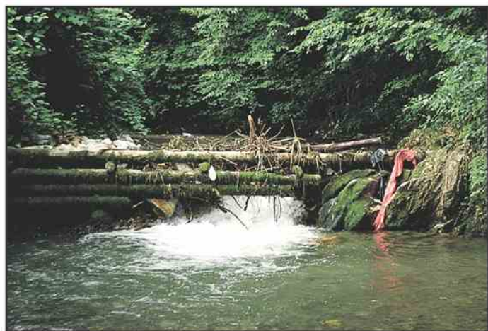
Pogled na jez je že julija pričal o nujni sanaciji
