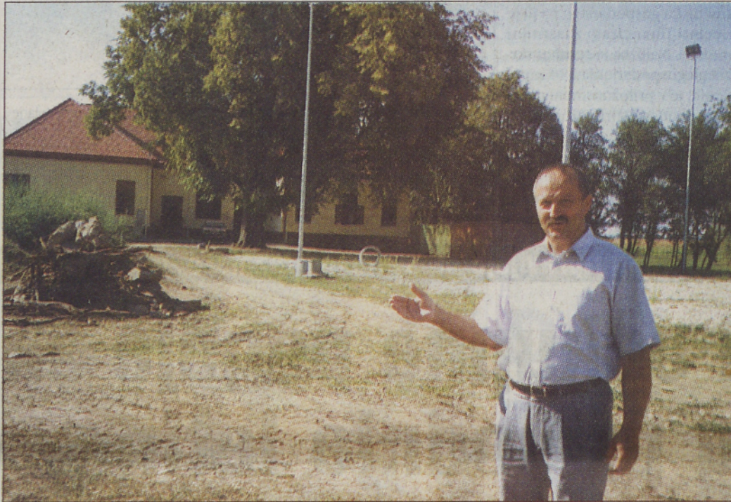
Predsednik vaškega odbora Kupšinci Jože Recek na gradbišču športno-rekreacijskega centra. Foto: F. Š.
