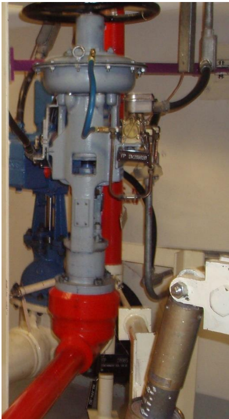
Slika 71: Izolacijski ventil, na katerem je NEK izvajala dela v neustreznem časovnem oknu (Foto: inšpekcija URSJV)
