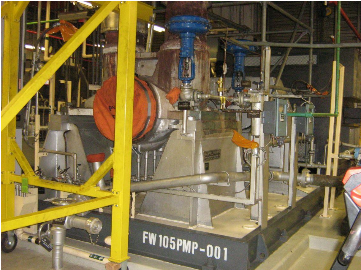
Slika 72: Delovišče črpalke glavne napajalne vode št. 1 (Foto: inšpekcija URSJV)
