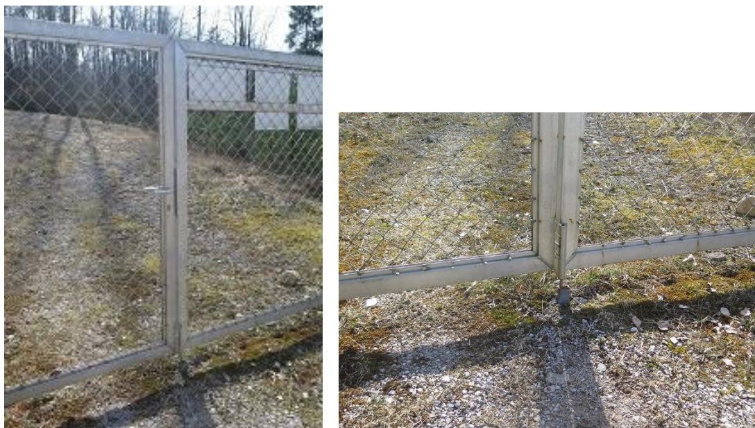
Slika 89: Vhodna vrata na severni dostopni cesti (zamik zaradi plazenja), stanje 2018 (levo) in stanje po popravilu vrat 2019 (desno) (foto: RŽV)
