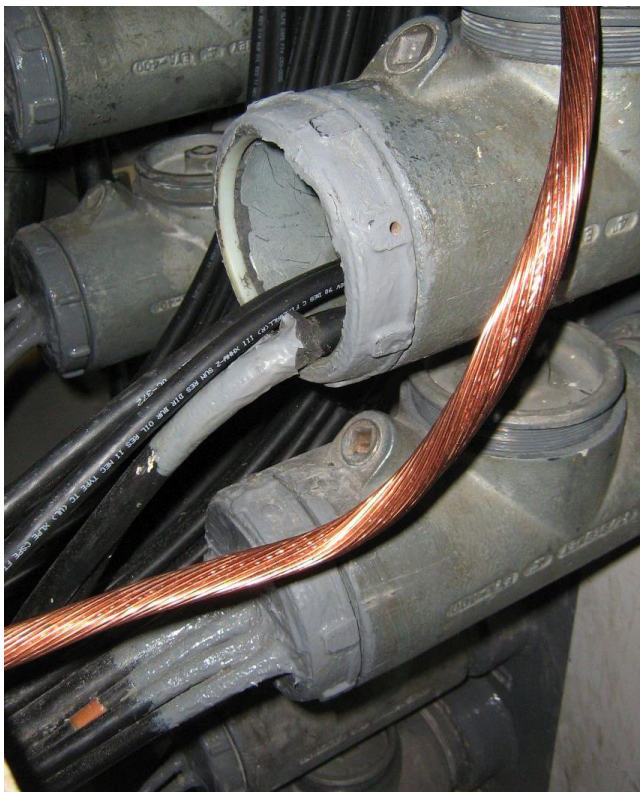
Slika 68: Penetracije kabelskih povezav med pomožno zgradbo in zgradbo z nizko in srednje radioaktivnimi odpadki (Foto: inšpekcija URSJV)
