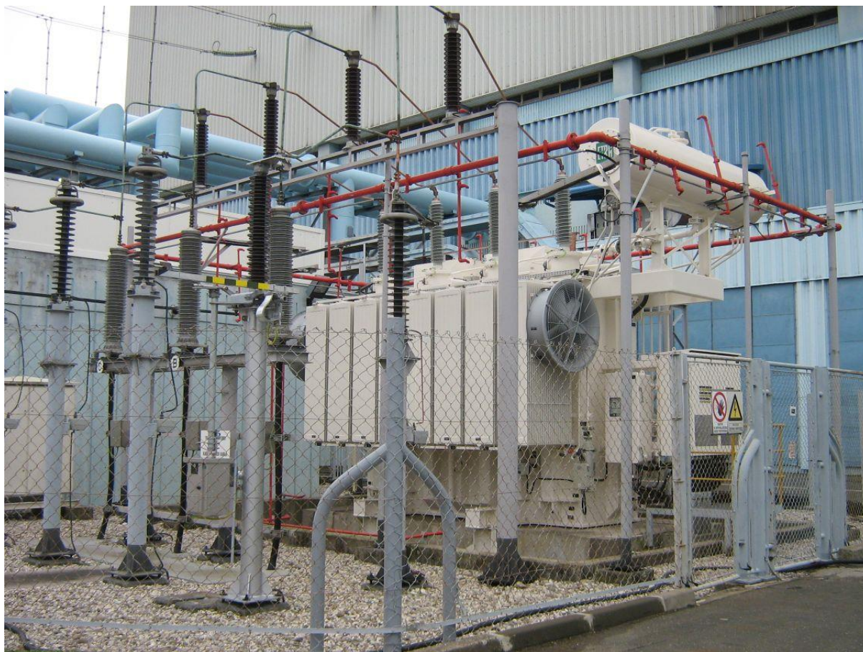
Slika 70: Novi transformator lastne rabe T3, vgrajen med remontom 2019 (Foto: inšpekcija URSJV)
