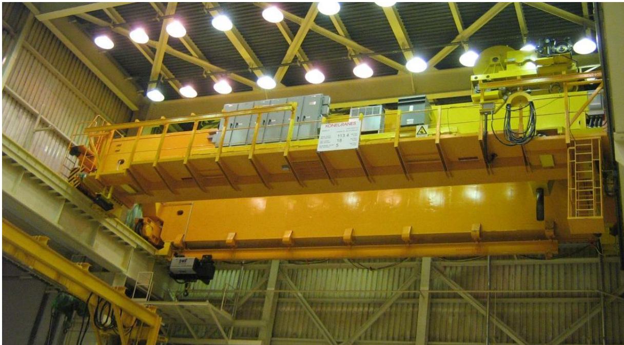
Slika 73: Mostno dvigalo v zgradbi za ravnanje z gorivom (Foto: inšpekcija URSJV)
