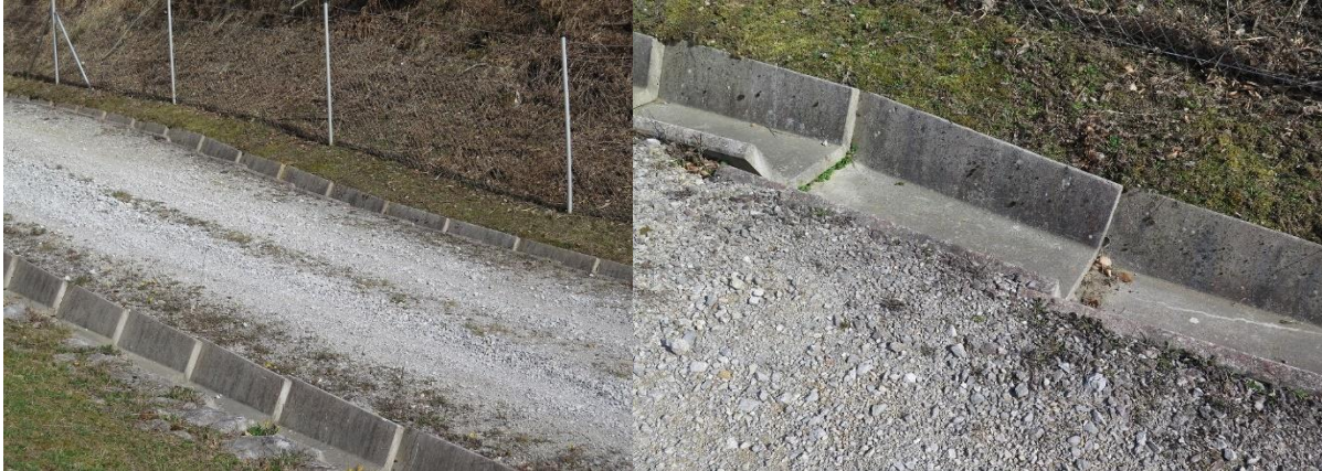
Slika 87: Zgornja cesta na odlagališču Boršt – južni del odlagališča, mesto posedka ceste (levo), zamik kanalet (desno) (foto: RŽV)
