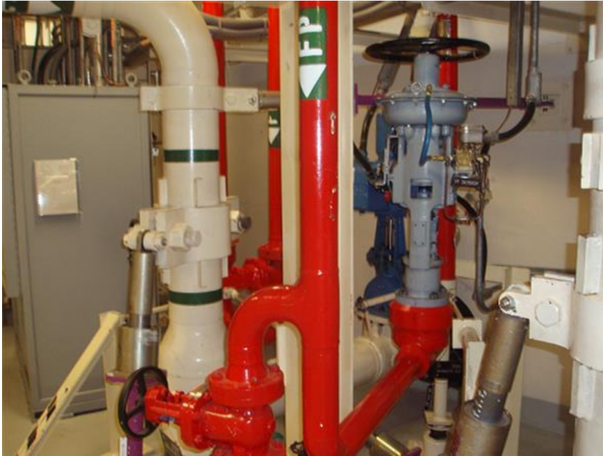
Slika 51: FP izolacijski ventil 28985 (ventil se nahaja na FP cevovodu za gašenje RCP št. 1)
