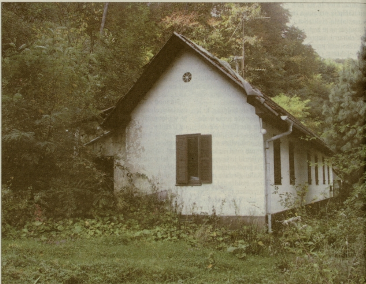
Še pred tremi leti je hiša Anice in Alfonsa Kumra na Partizanski 3 spominjala na pravljico; zdaj je sramota za Celje in Mestni park, hkrati pa zaradi nezačete sanacije zemeljskega plazov z Miklavškega hriba grožnja, ki visi nad življenjem Peerovih in Mlakarjevih.
