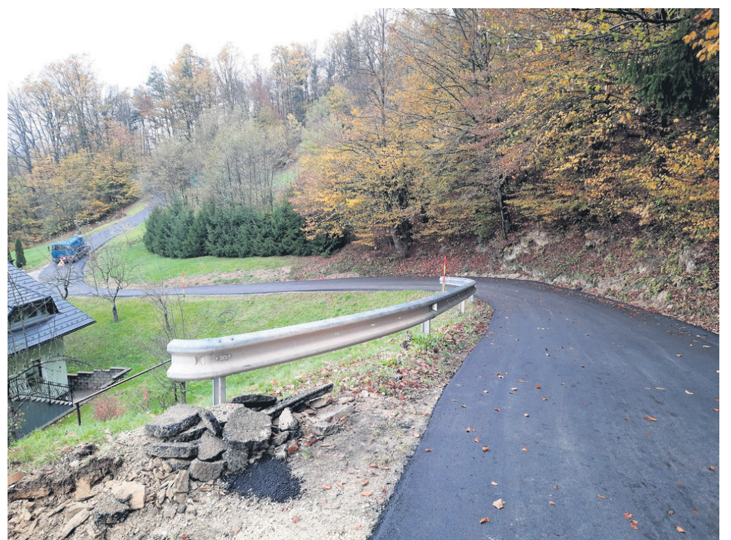
Ob gradnji javnega vodovodnega omrežja za območje Ojstro-Tovsto-Zahum-Brstnik je Komunala Laško preplastila tudi odsek lokalne ceste v dolžini 850 metrov. (Foto: Občina Laško)
