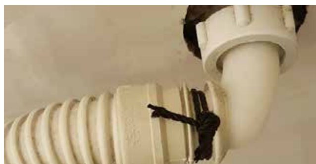
Slika 8b : Zatesnitev odtočne cevi pralnega stroja.
