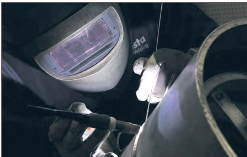
Slika 1. Ročno obločno varjenje z oplaščeno elektrodo in varjenje TIG, ki je prikazano na sliki, se danes v razvitem svetu še vedno veliko uporabljata
