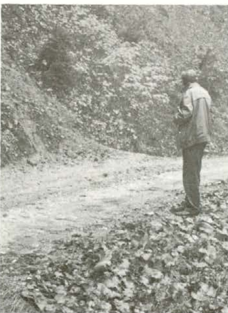
Popis poškodb na cesti Jurin—Končev hlev — Foto: Gorazd Mlinšek
