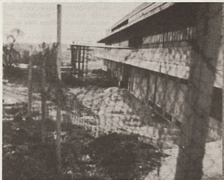
Pred Mitterandovim obiskom postavljena ograja je že podrtá.
