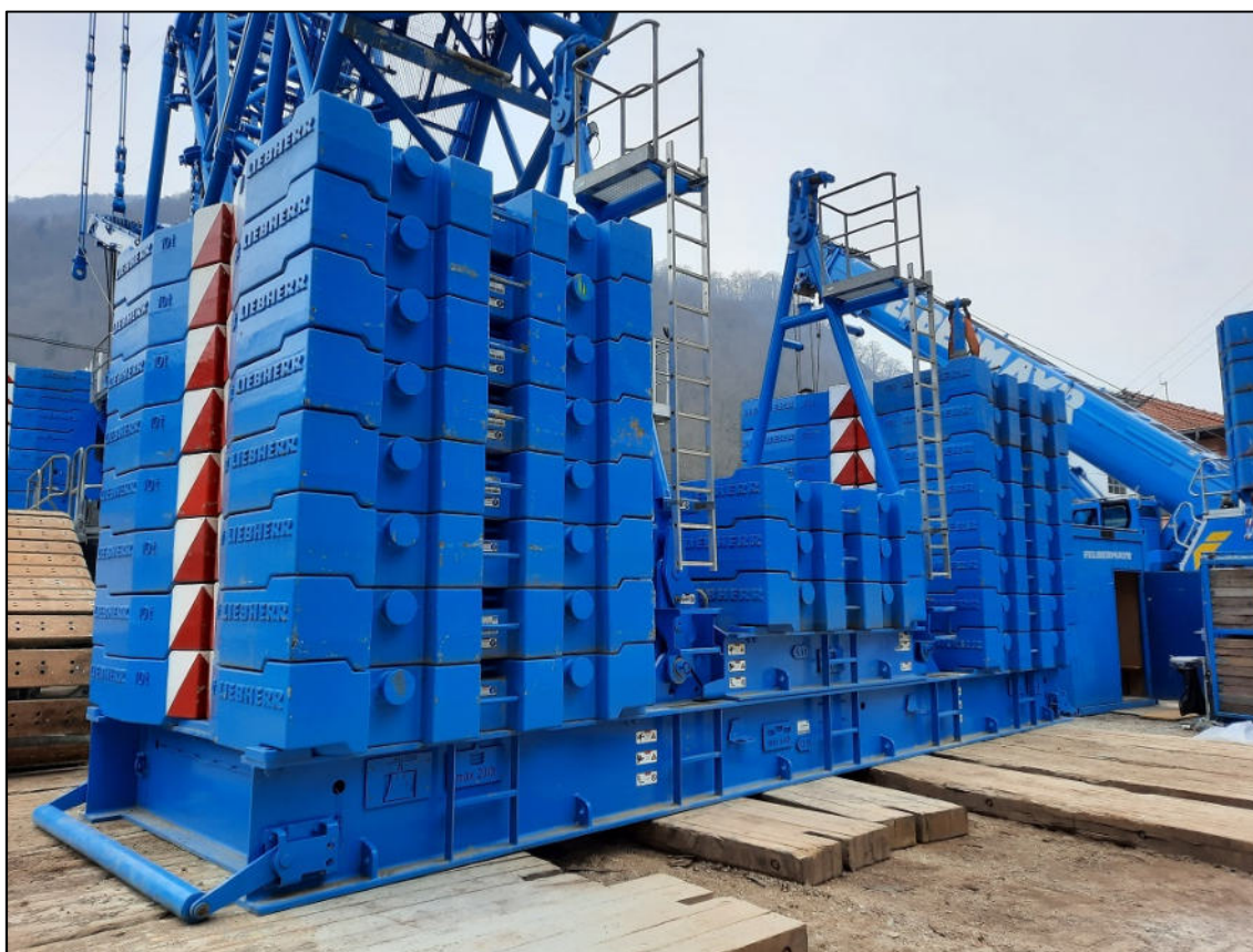
Viseča protiutež z maso \sim 400 t za dvig transformatorja. (Avtor: mag. Klemen Ponikvar)
