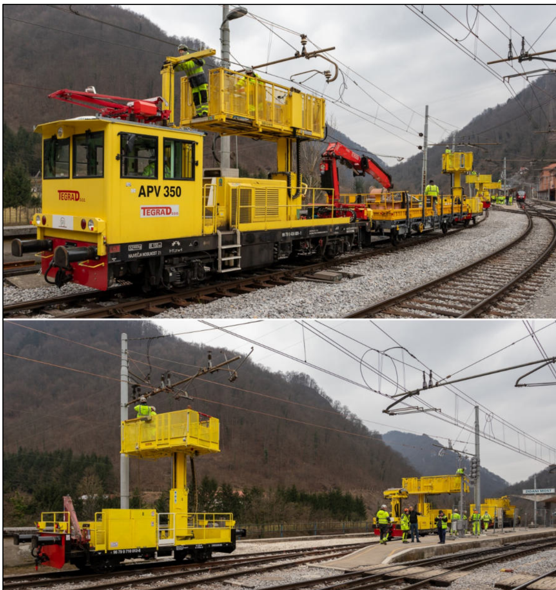
TMD TegrAD APV 350 in vagoni z dvižno platformo, 19. februar 2023. (Avtor: Bojan Dremelj)
