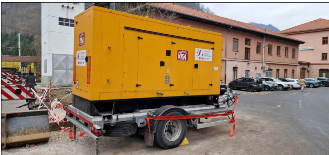
Dizelski agregat za napajanje odjemalcev v Zidanem Mostu. (Avtor: Bojan Dremelj)
