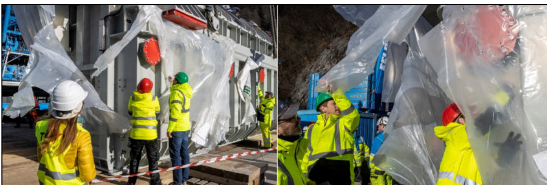
Pregled morebitnih poškodb pod zaščitnim polivinilom, 4. februar 2023. (Avtor: Miško Kranjec)
