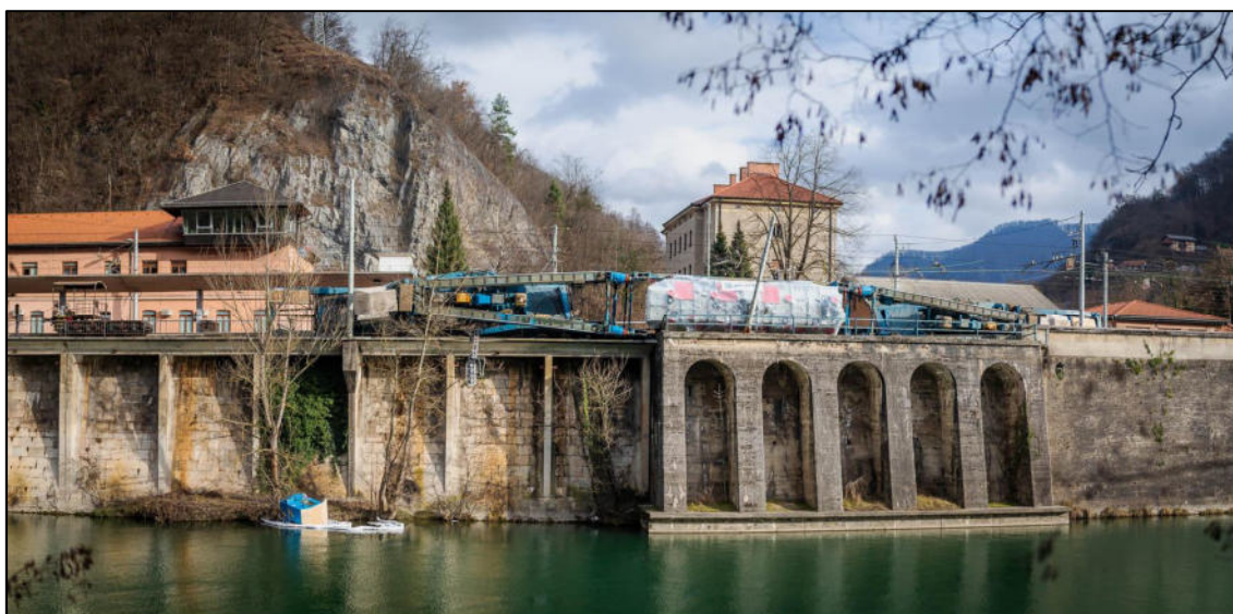
Pogled na transformator z nasprotnega brega Save, 8. januar 2023. (Avtor: Bojan Dremelj)
