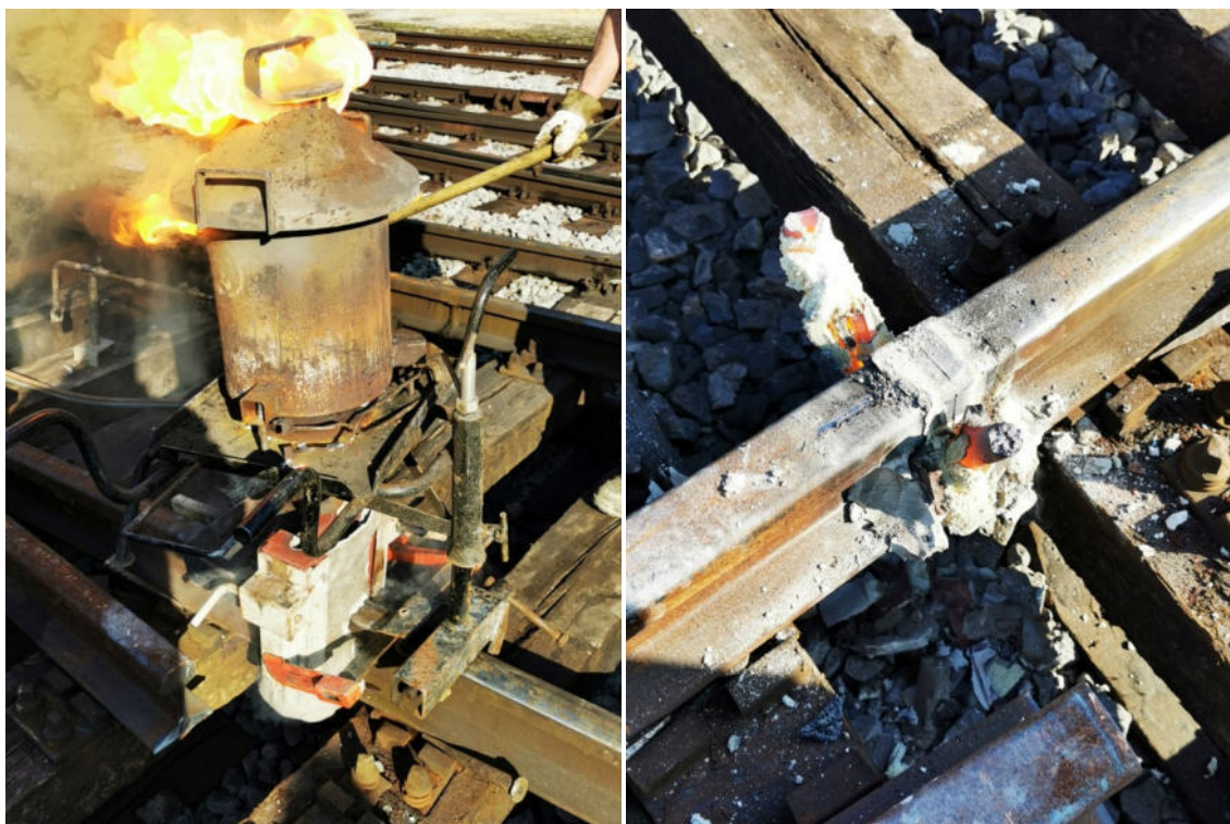
Oprema za termitsko varjenje med postopkom varjenja in var na kretnici št. 14, ki ga je potrebno še obdelati, februar 2023. (Avtor: Metal Industry - Facebook)
