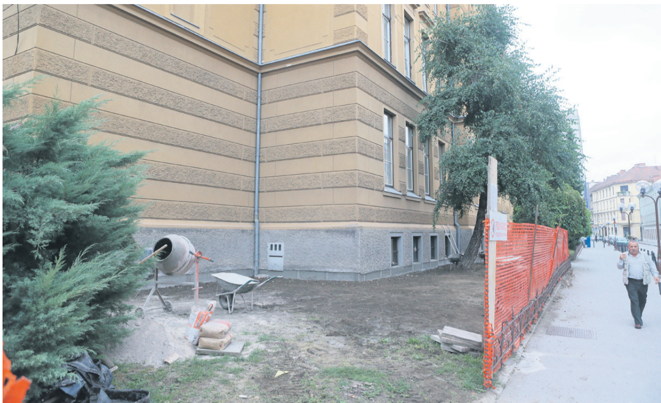
Obnova hidroizolacije dela III. OŠ Celje, kjer so garderobni prostori, se bo pod skrbnim nadzorom strokovnjakov zavoda za varstvo kulturne dediščine zavlekla še krepko v september.
