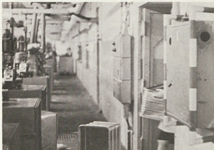
Tudi v oddelku predilnice sintetike smo mehansko zaščitili hidrantne omarice (na skrajni desni strani slike).
