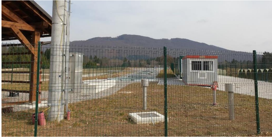
Čistilna naprava v januarju 2022.
