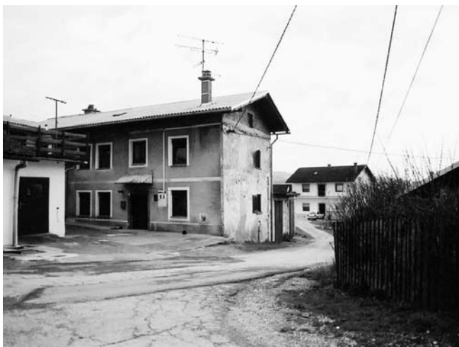
Hiša Zarečje 47. Levo: Na novo in na nov način prekrita hiša. Desno: Ista stavba z odstranjenimi še preostalimi elementi oblikovanja fasade in zamenjanim stavbnim pohištvom.
