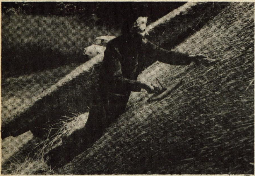
SKOFJA LOKA - Kodarjev Miha, eden zadnjih streharjev, je še vedno krepak, žilav, predvsem pa večš svojega dolgoletnega dela na strehi... Foto: F. Perdan
