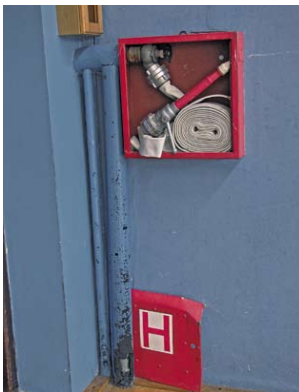
Slika 1. Nezaščiten in poškodovana hidrantna omarica v športni dvorani.
