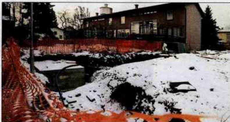
Stroji na zelenici ob Mrakovi 1 že nekaj časa stojijo, stanovalci ugotavljajo, da se je začela udirati cesta, gradbeni stroji pa naj bi uničili tudi jašek na začetku nekdanjega zelenega pasu ob Mrakovi 1. / Foto Tina Dokl
