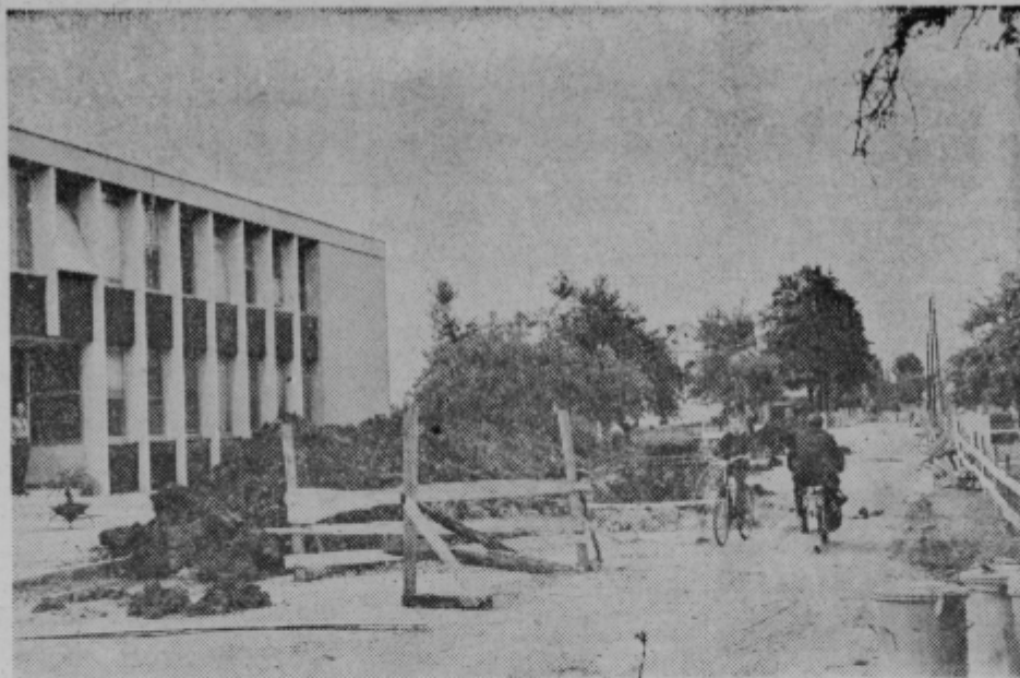
Končno so tudi na Dečkovi cesti v Celju začeli z deli, ki med ljudmi vzbujajo upanje, da bo tudi mimo njihovih hiš čez nekaj časa cesta prevlečena z asfaltom ter opremljena tako, kot se za moderno cesto spodobi. (Foto: L. Srše)
