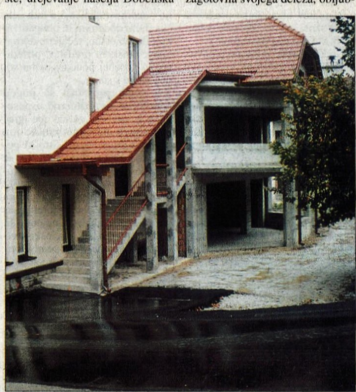
Ko so se v Poljanah odločili, da v Kulturnem domu uredijo prostore za pošto, je bilo potrebno dozidati tudi nov vhod v dvorano. Prizidek za garderobe in knjižnico, ki je še v surovem stanju, je stal več kot 10 milijonov tolarjev, pri čemer je občina prispevala polovico.
