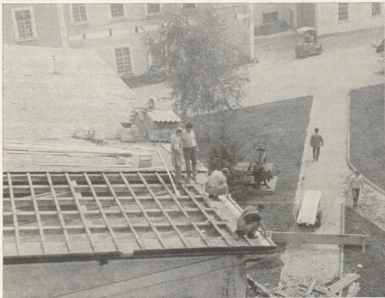
No, tudi v ambulanto in v elektro delavnico ob nalivih ne bo več curljalo; streha stavbe bo na novo prekrita še pred glavnim jesenskim deževjem
