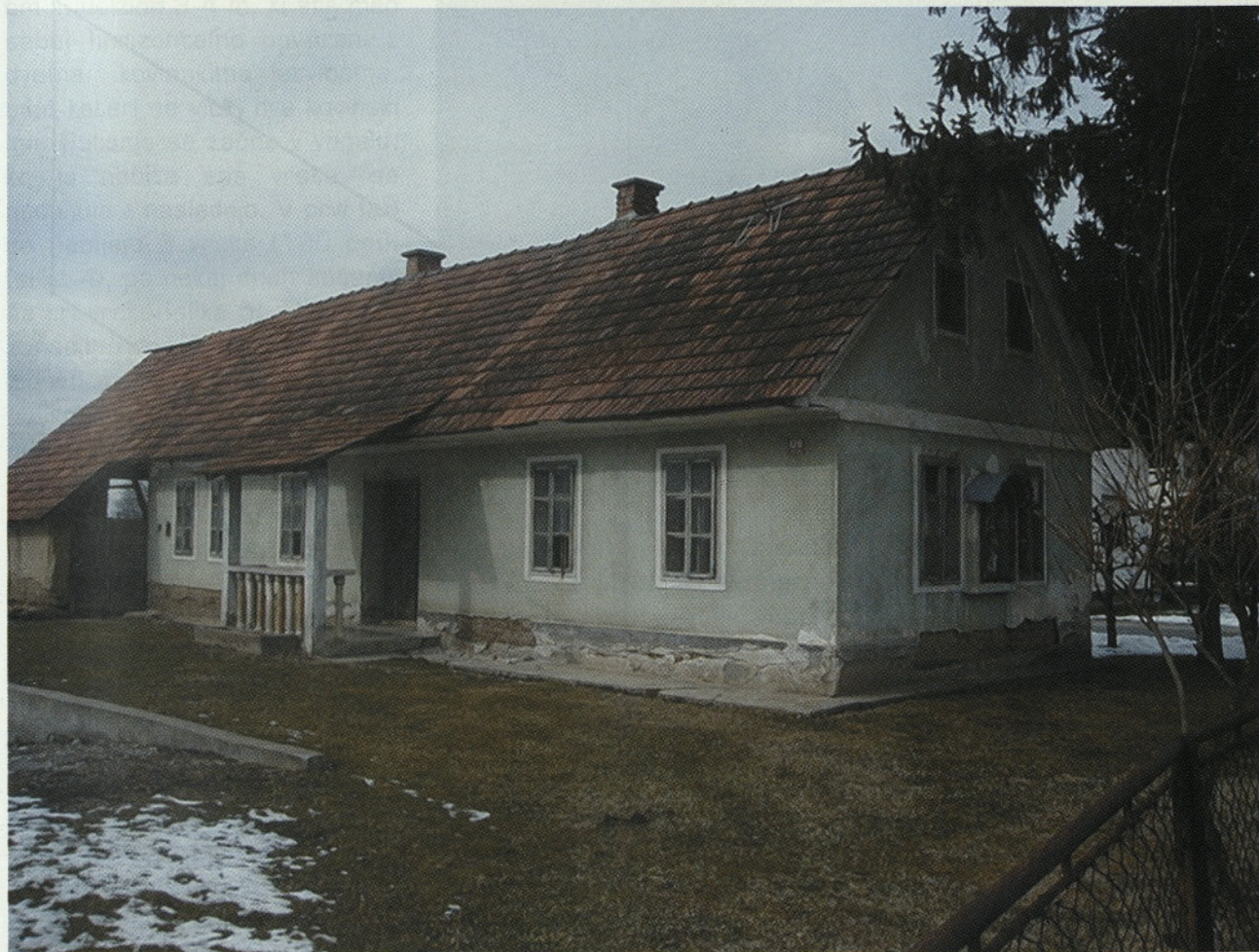
Slika 3. Butana hiša v Stonjcih, na kateri so dobro vidne poškodbe zaradi nepravilne zaščite pred vodo in vlago (foto: M.Z.S.)
