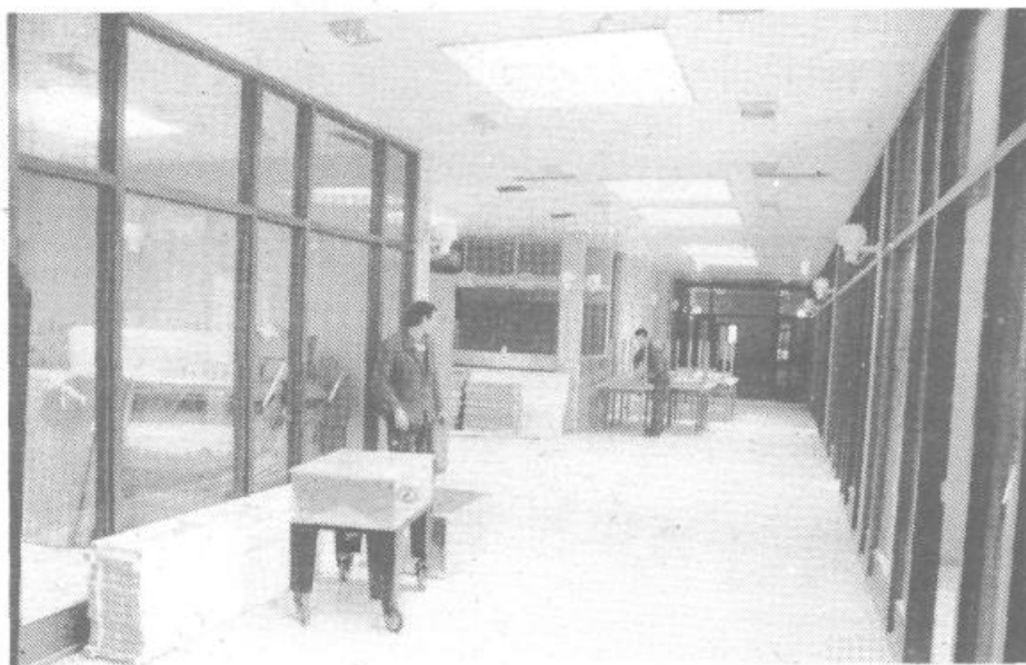
V novem domu, zgrajenem za starejše občane, potekajo zaključna dela pri opremljanju
