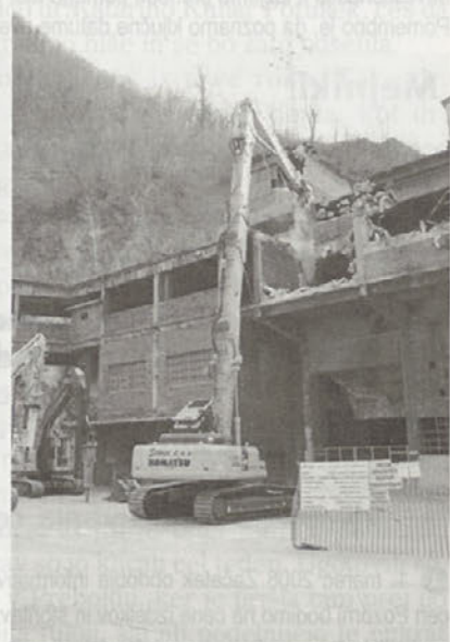
Sekopt bo ves material, ki bo ostal od porušene zgradbe, recikliral z najnovejšo pridobitvijo
