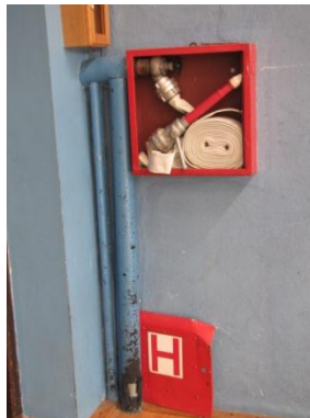
b)zvita in odlomljena vrata hidranta v dvorani
