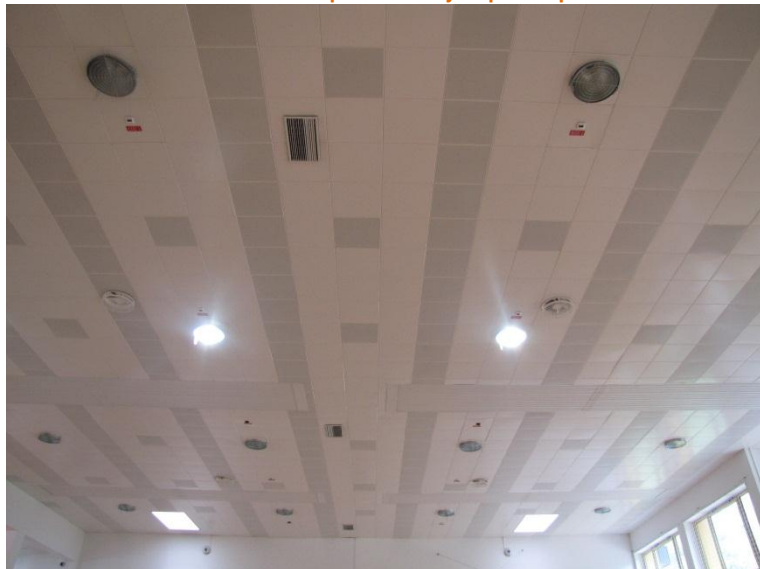
Slika 28: Primer enakomerne razporeditve sijalk po stropu
