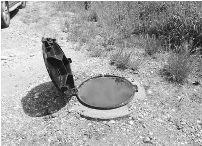
Izliv fekalne vode pri čistilni napravi v Janežovcih
