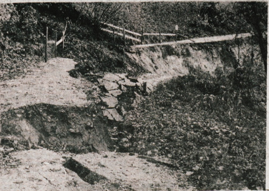
Možjanca — Okoli 700 metrov pod vasjo Možjanca je zemeljski plaz prejšnji teden odtrgal del ceste, tako da je povsem pretrgana zveza z dolino. Krajanji sicer hodijo zdaj peš do Preddvora, vsak nujen prevoz pa je za sedaj nemogoč. Hudi nalivi prejšnji teden so močno poškodovali tudi cesto na Podblici in v Babnem vrtu. — L. M. — Foto: F. Perdan
