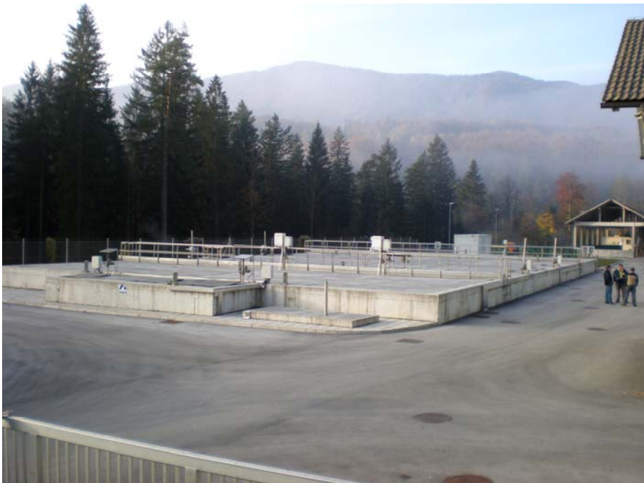
Slika 5: Centralna čistilna naprava Radovljica – dva pokrita SBR reaktorja (21.10.2008)
