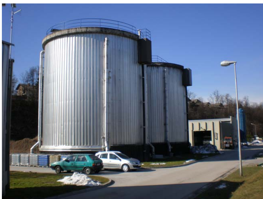
Slika 8: Primarno in sekundarno gnilišče (CČN Kranj, 12.2.2009)
