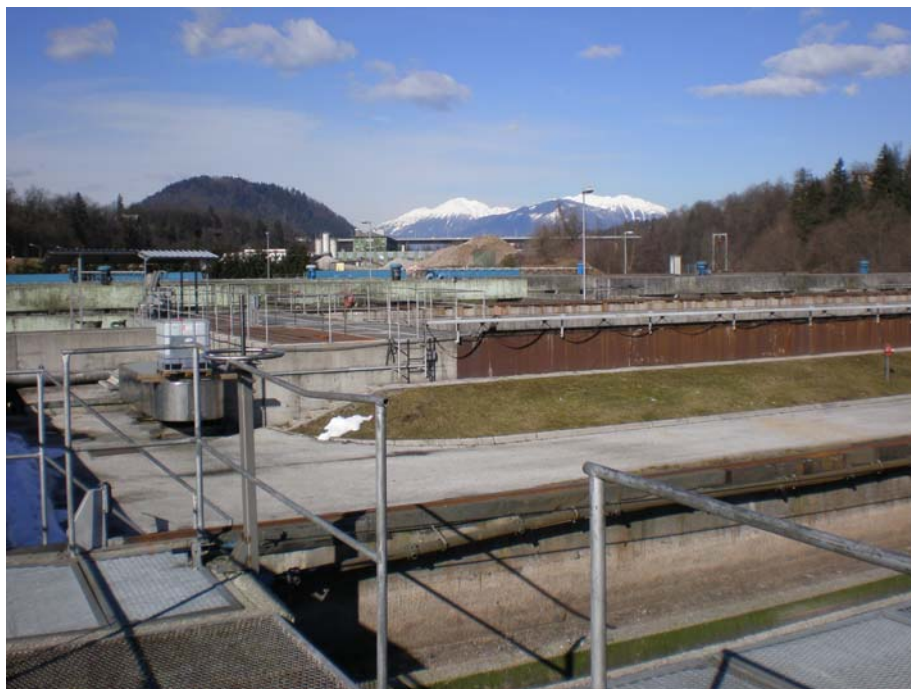
Slika 6: Centralna čistilna naprava Kranj (Zarica) – klasičen postopek biološkega čiščenja odpadne vode s primarnim in sekundarnim usedalnikom (12.2.2009)
