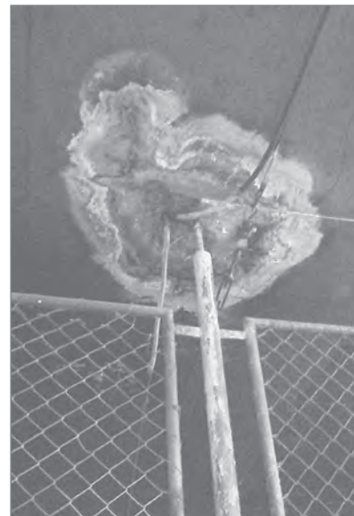
Slika 2: Zamakanje na stropu garaže na mestu, kjer poteka napeljava javne razsvetljave (foto: Andrej Ciuha).
