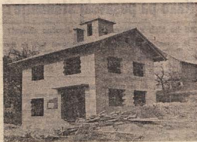
Gasilski dom v Zapotoku je že pod streho. S prostovoljnimi delom so ga zgradili prebivalci Zapotoka in Vinic. Začeli so junija letos, v oktobru pa je bil pod streho. (Foto: Drago Mohar)
