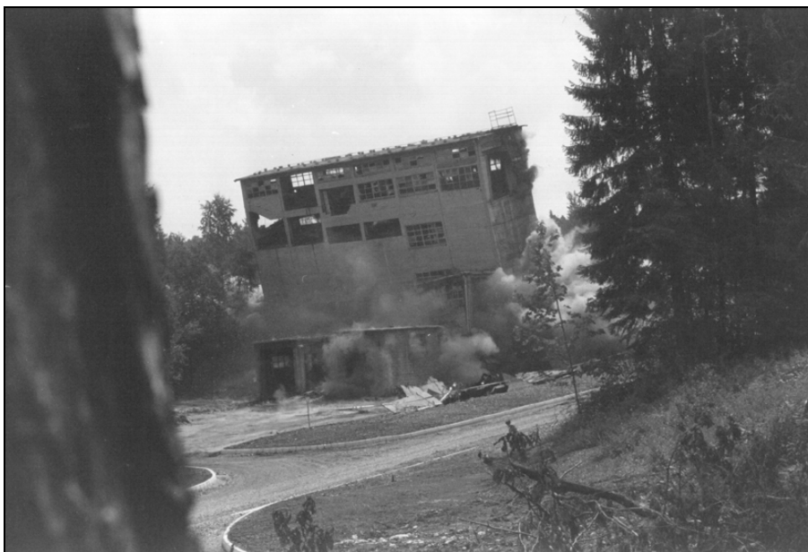
V avgustu 1997 je bila porušena zgradba separacije v premogovniku Kanižarica (foto: Jože Malešič).
