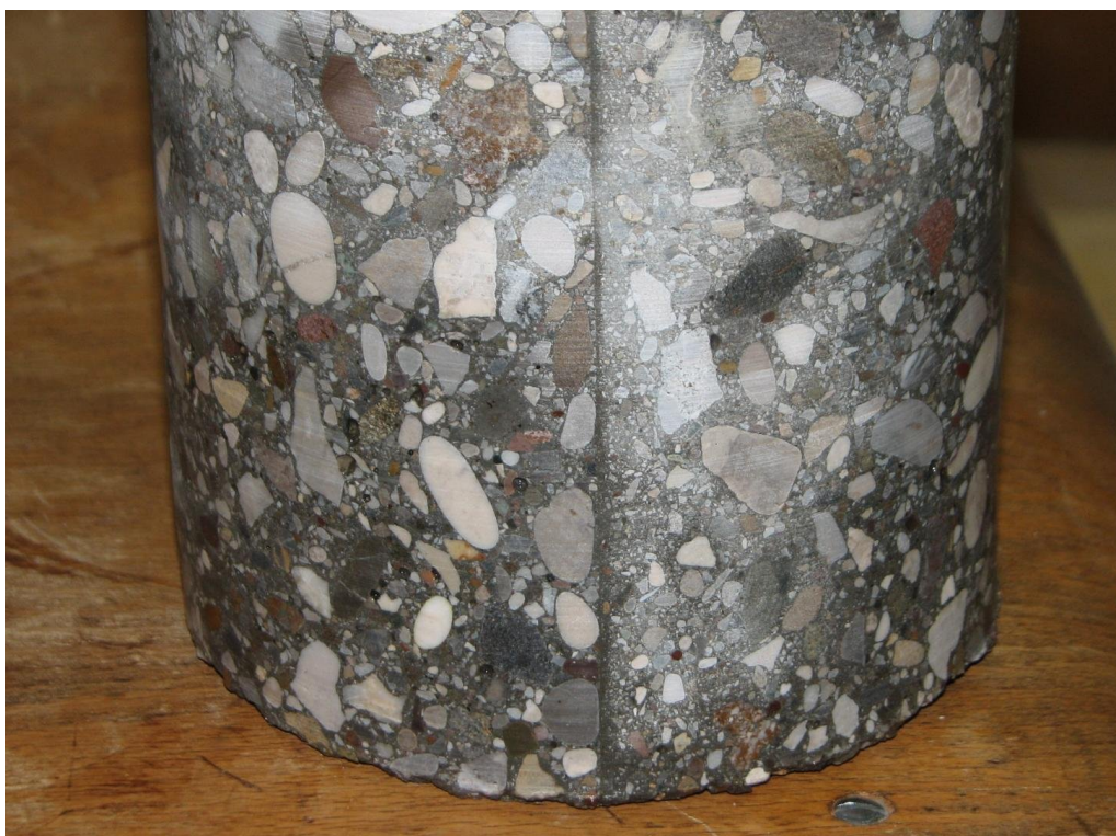
Slika 34: Hladni stik dveh plasti betona
